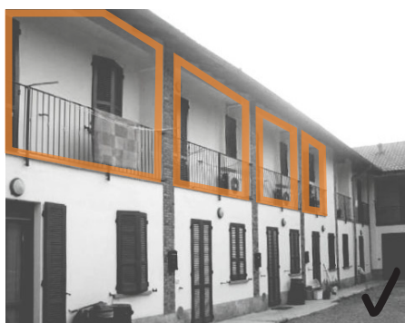
Tamponamento "pieno" su piano terra e piano superiore, con arretramento del piano superiore creando un ballatoio
